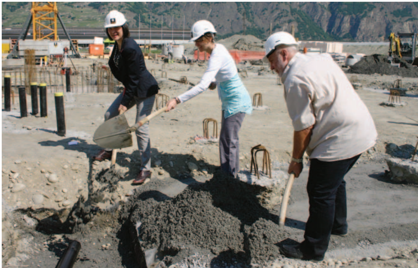
Esther Waeber-Kalbermatten, conseillère d'Etat, Sarika Pilet, présidente de la Fondation du CAAD, et André Naudin, directeur de l'institution (de g. à dr.), ont symboliquement procédé hier à la pose de la première pierre des nouveaux locaux. LE NOUVELLISTE
